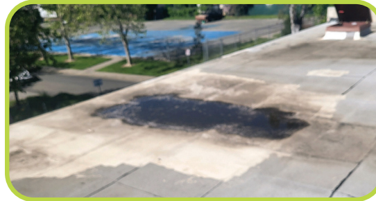
Techo con goteras
